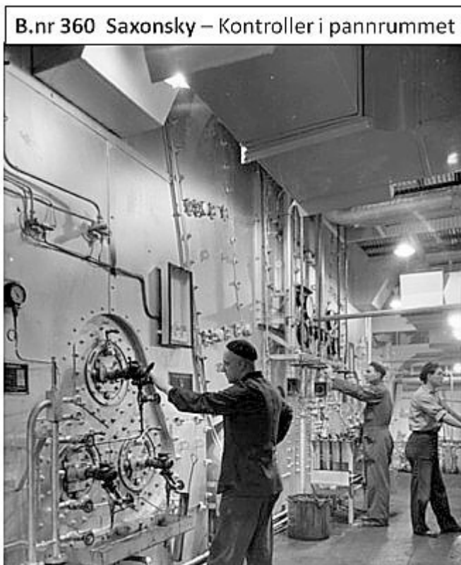
B.nr 360 Saxonsky – Kontroller i pannrummet.
