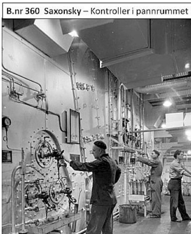
B.nr 360 Saxonsky – Kontroller i pannrummet.
